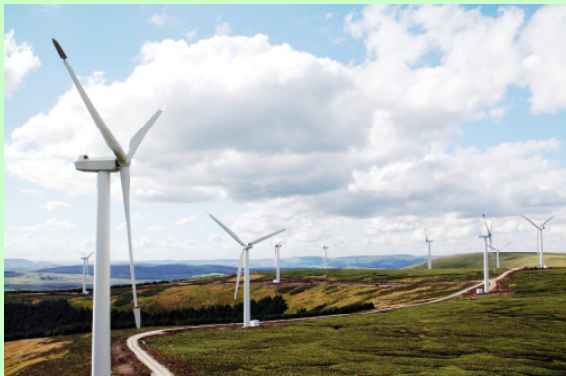
Windpark Bowbeat, E.ON UK, Moorfoot Hills, Großbritannien
